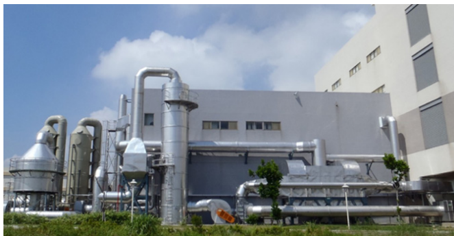
VOCs 冷凝濃縮系統
